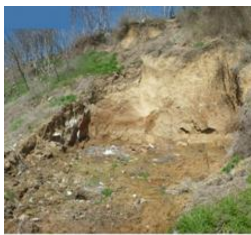
Рис. 2. Возникновение отдельных оползневых блоков
