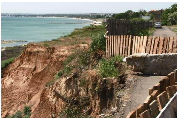
Рис. 3. ул. Приморская в с. Крыжановка в оползневой зоне
