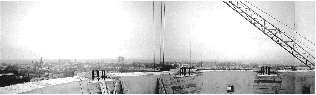
Рис. 7. Залізобетонне кільце, до закладних металевих деталей якого кріпляться металеві конструкції шпиля дзвіниці
