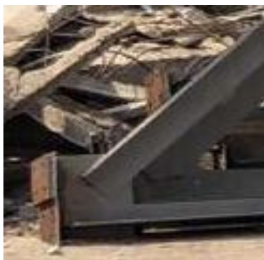
Рис. 3. Деформації опорних фланців опорних вузлів ферми
