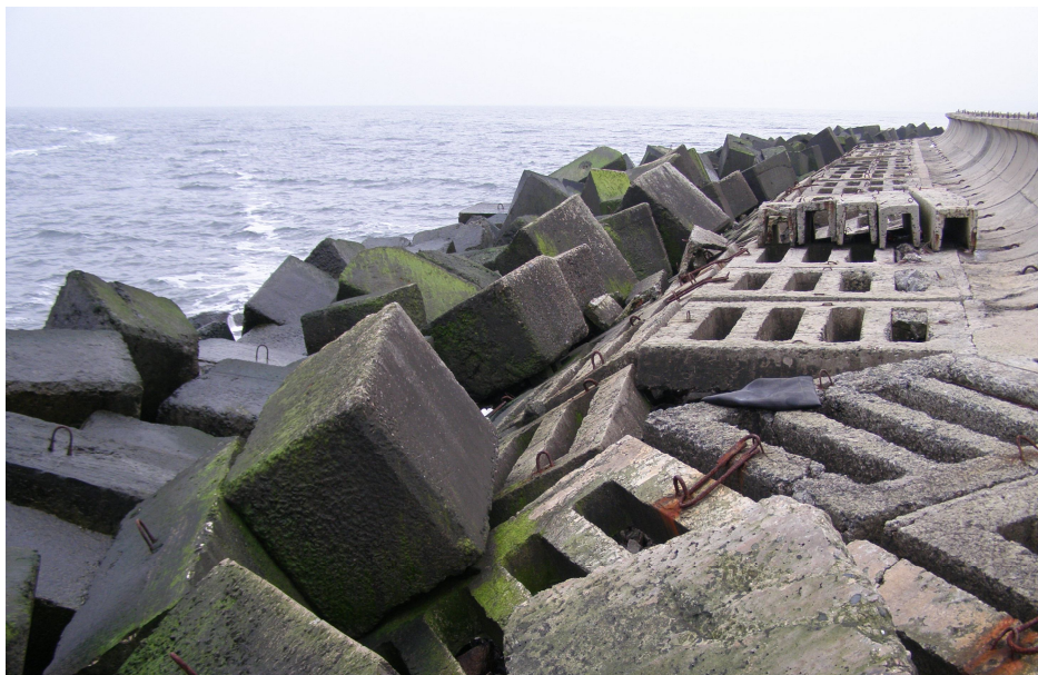
Рис. 1. Берегозащита бетонными массивами
