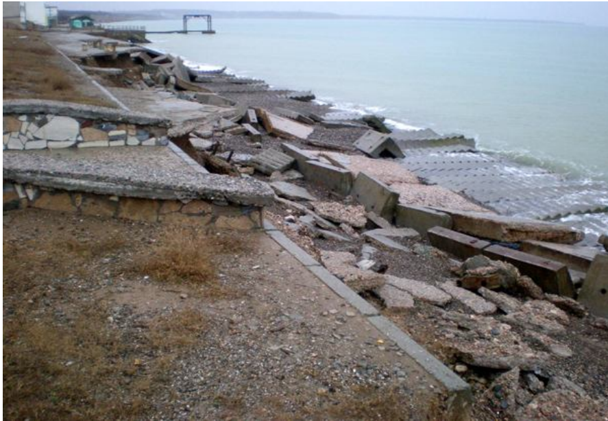
Рис. 2. Разрушение берегозащитных сооружений от штормовых волн
