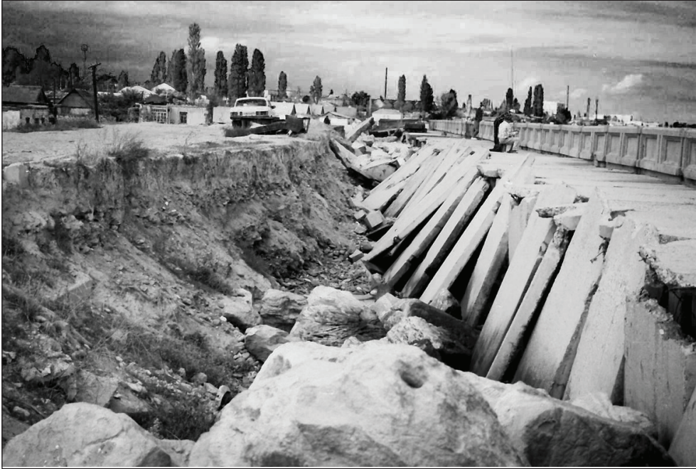
Рис. 1. Разрушение берегозащитных сооружений на побережье Каспия (г. Дербент) (фото Г.Л. Коффа)
