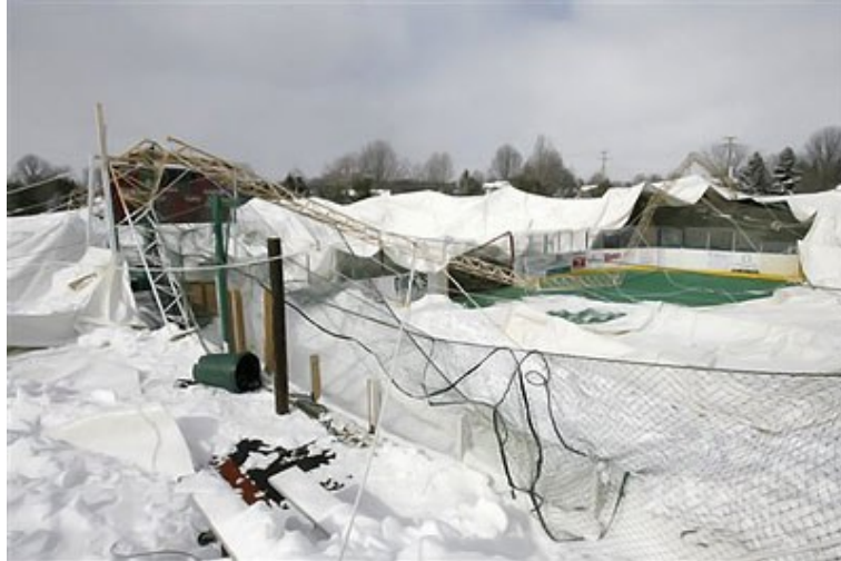
Рис. 1. Руйнування легких конструкцій під дією снігу
