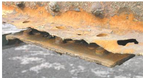
Рис. 2. Разрушение узлового соединения в результате коррозионного износа
