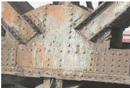
Рис. 7. Коррозионный износ элементов узла
