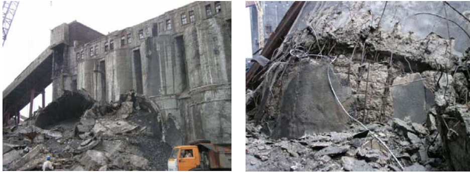
Рис. 1. Обрушение силосов при потере устойчивости положения. Дефекты бетонирования и коррозионные поражения арматуры
