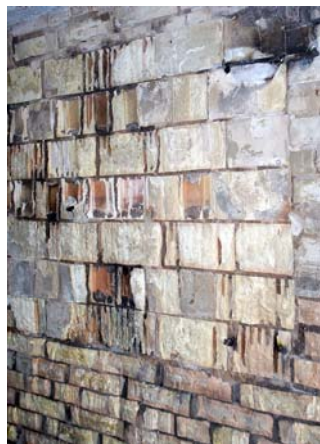
Рис. 1. Руйнування поверхневих прошарків цегляної кладки після пожежі в квартирі житлового будинку
