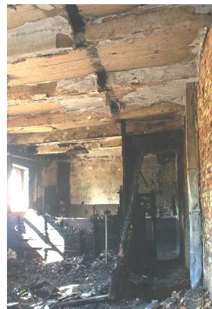
Рис. 2. Руйнування поверхневих прошарків цегляної кладки і бетону монолітних конструкцій перекриття після пожежі
