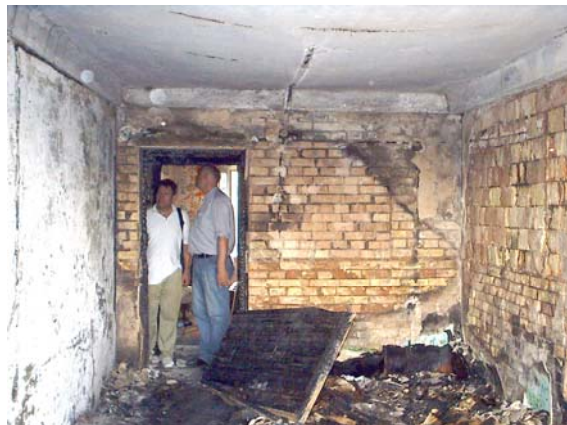
Рис. 2. Загальний вигляд конструкції шатрової плити, яка отримала пошкодження під час пожежі і гасіння (руйнування захисних прошарків бетону, оголення арматури, прогини плити понад 80 мм тощо)
