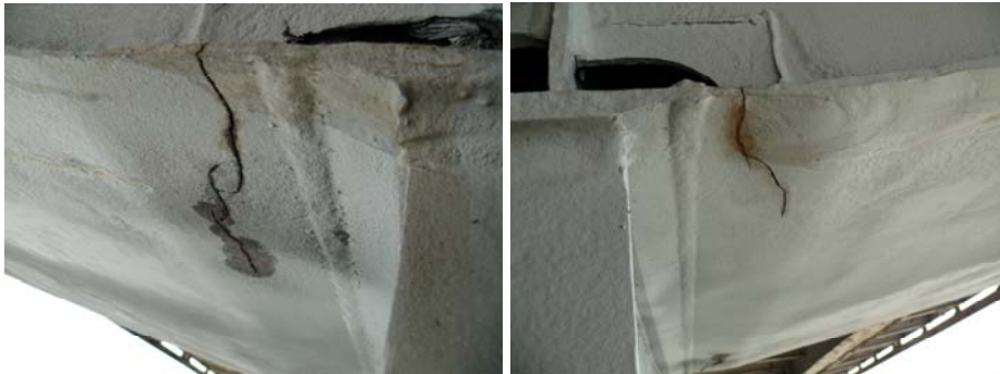
Рис. 3. Ослабленные коррозией нижние пояса несущих ригелей
