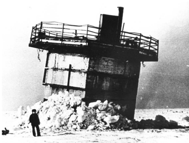
Рис. 3. Наклон железобетонной опоры при подвижке льда (Азовское море)
