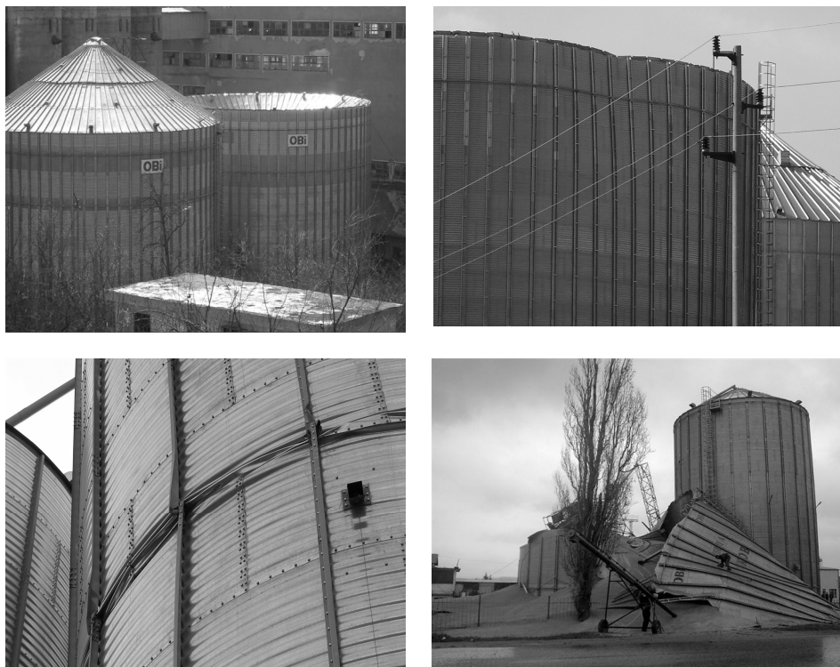
Рис. 3. Відмови та аварії сталевих силосних ємностей з конструктивною схемою на основі гофрованих листів
