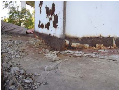
Рис. 13. Коррозия металла основания колонн
