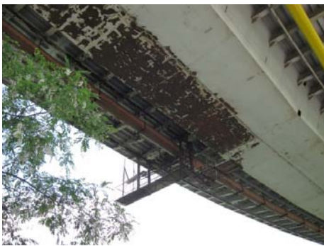
Рис. 7. Разрушение антикоррозионного покрытия пролетного строения
