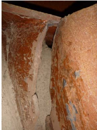
Рис. 4. Трещина и смещение кромок в стенке тяги
