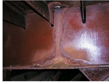
Рис. 10. Место разрушения грунтовки, поверхностная коррозия
