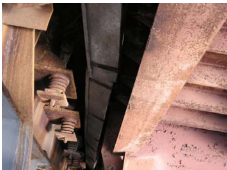
Рис. 15. Разрушение уравнивательных приборов деформационных швов
