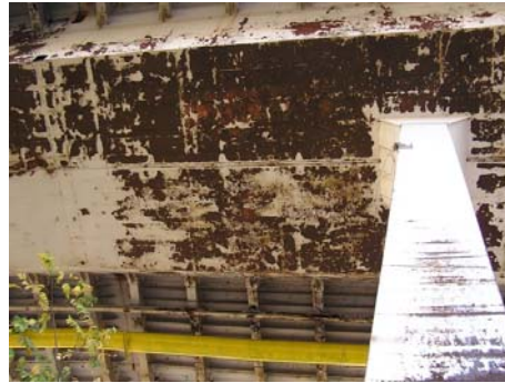
Рис. 14. Разрушение антикоррозионной защиты колонн и пролетного строения
