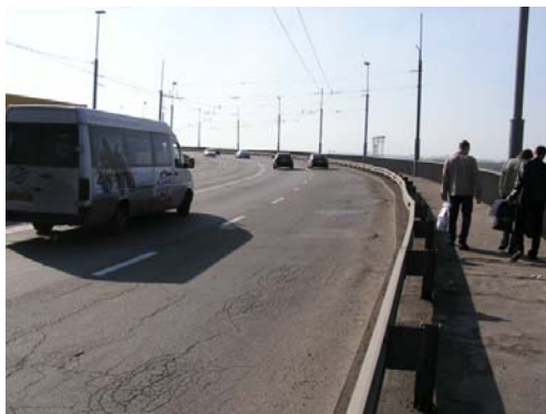
Рис. 17. Дефекты асфальтобетонного покрытия проезжей части
