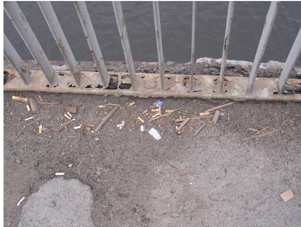
Рис. 19. Коррозионные дыры в нижней тетиве перильного ограждения
