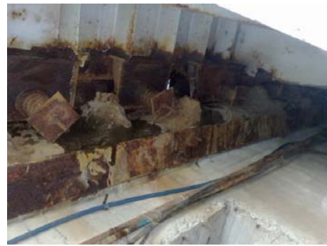
Рис. 12. Отсутствие водоотводных лотков под деформационным швом
