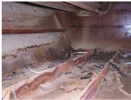
Рис. 11. Разрушение антикоррозионного покрытия, мусор
