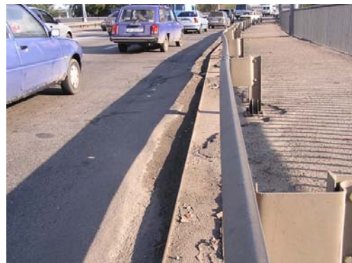
Рис. 18. Разрушение асфальтобетонного покрытия тротуаров
