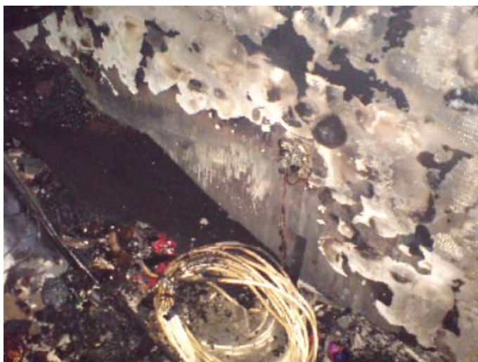
Рис. 1. Подовжувач, який був підключений до електромережі
