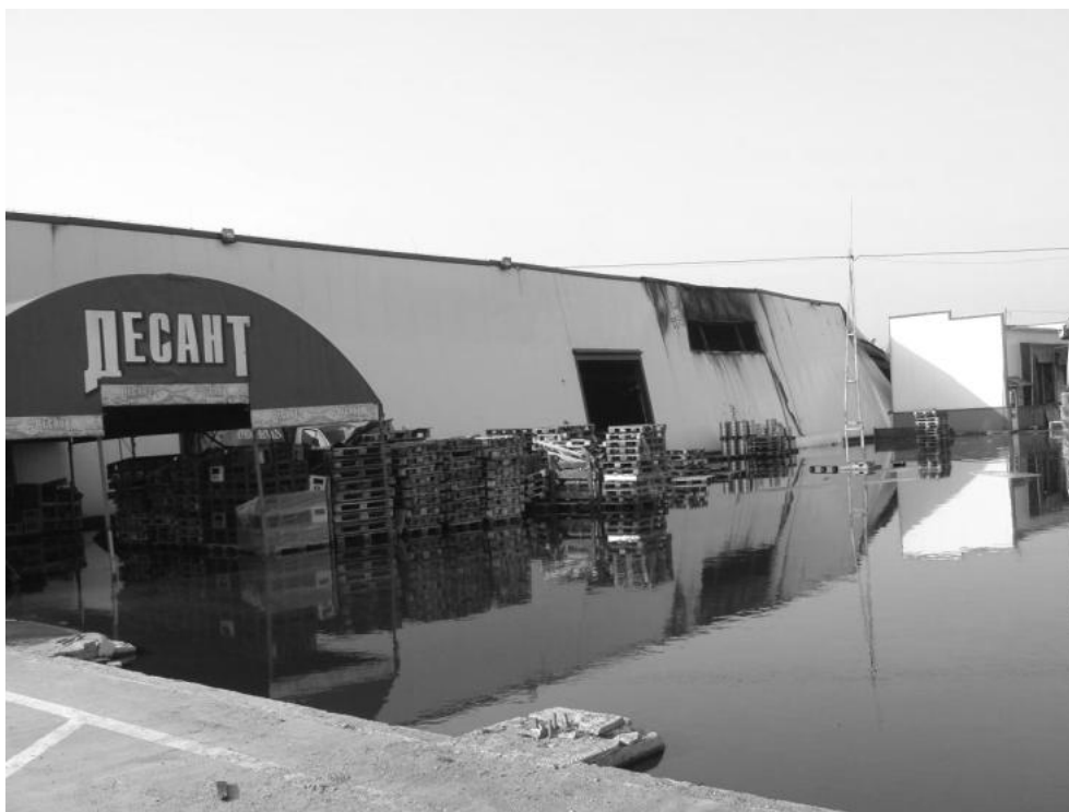
Рис. 3. Фасад будівлі в осях Г-Т після пожежі
