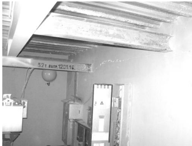
Рис. 8. Горизонтальна тріщина в місці обпирання сталеві балки на стіну
