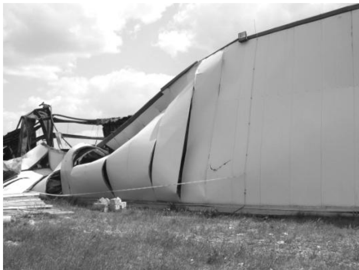
Рис. 4. Фрагмент фасаду будівлі в осях Т–Г після пожежі
