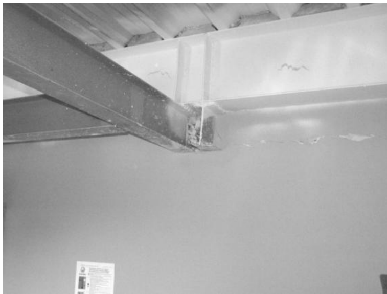
Рис. 10. Горизонтальна тріщина в місці опирання прогону на цегляну стіну
