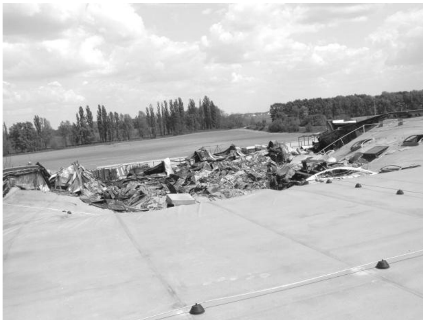
Рис. 6. Вигляд обвалених конструкцій будівлі в осях Г–Т (вигляд із покрівлі)
