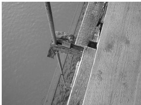
Рис. 7. Корозія металу несних елементів оглядових проходів
