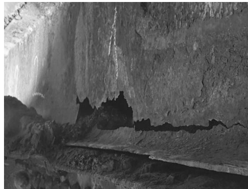
Рис. 4. Руйнування поперечної балки на опорі № 25
