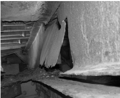
Рис. 3. Руйнування поперечної балки на опорі № 1
