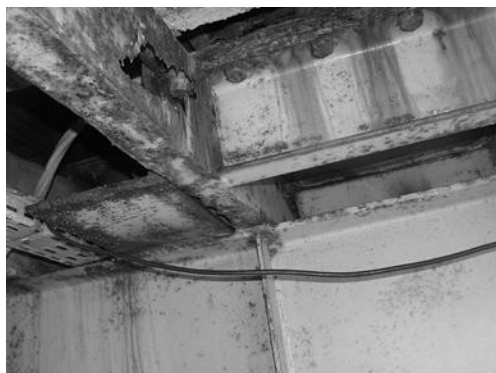
Рис. 9. Корозійне руйнування балочної клітки стовпа освітлення № 18
