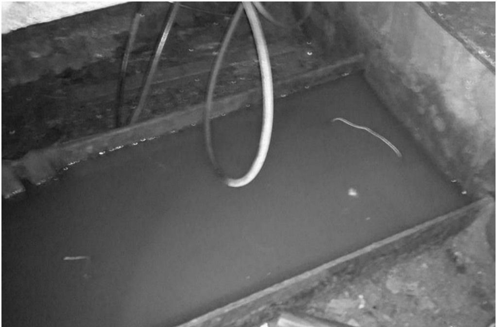
Рис. 19. Застій води, яка потрапляє крізь деформаційний шов на нижній пояс коробчастої балки, призводячи до корозії металу
