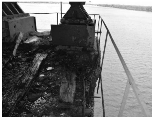
Рис. 5. Сколи бетону, оголення та корозія арматури підферменників опори № 11
