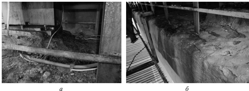
Рис. 27. Засміченість ригелів опор і пошкодження антикорозійного захисту опорних частин ( а ) і пошкодження бетону ригелів опор та їх захисного фарбового покриття ( б )
