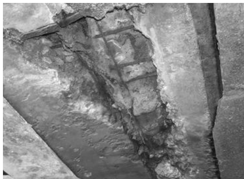
Рис. 8. Руйнування захисного шару бетону плити проїзної частини
