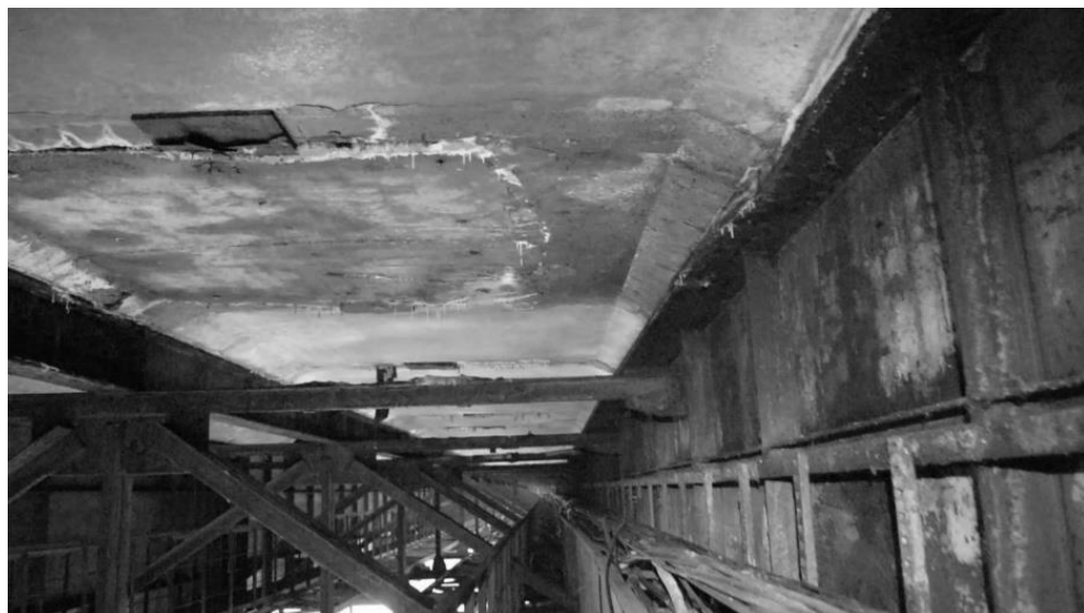
Рис. 20. Просочування води у сталезалізобетонних прогонових будовах
