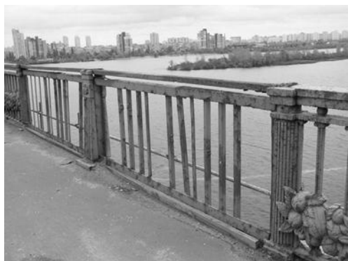
Рис. 10. Руйнування секції перильної огорожі та її кріплення, відрив декоративних елементів
