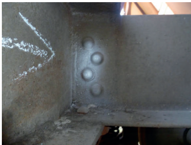
Рис. 4 – Тріщини в хребтовій балці вагонів-зерновозів
