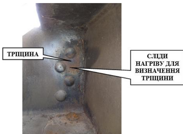
Рис. 8 - Рама кузова вагона-зерновоза за наслідками виявлення тріщини газополум'яним способом
