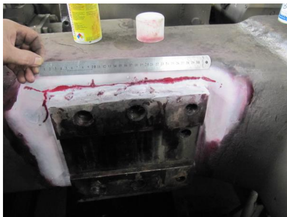
Тріщина рами візка
