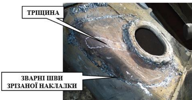
Рис. 11 - Тріщина що виникла під «посилюючою» накладкою
