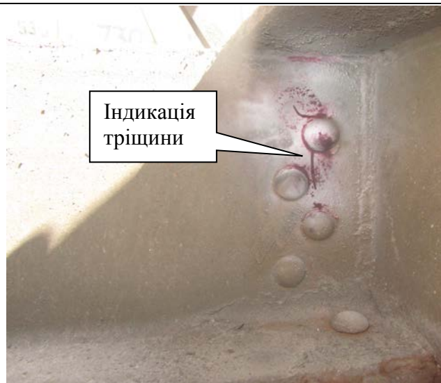
Рис. 3 – Дефекти несучої металоконструкції РС виявлені за допомогою наборів для проведення РТ контролю
