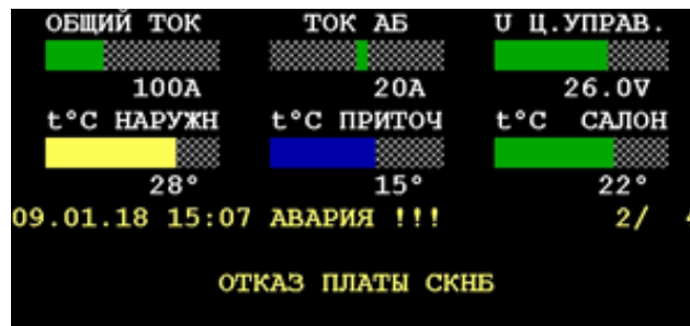
Рис. 19 – Повідомлення про аварійну відмову плати СКНБ
