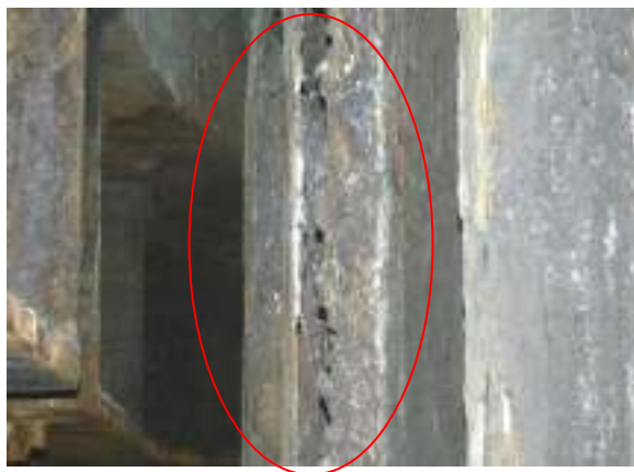
Рис. 1 – Результат коррозионного износа опоры поворотного стенда МНЛЗ
