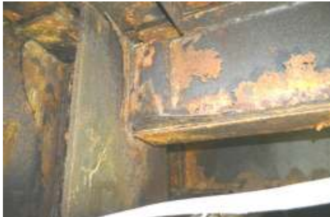
Рис. 3 – Результат корозійного износа металоконструкції МНЛЗ (перекрыття)
