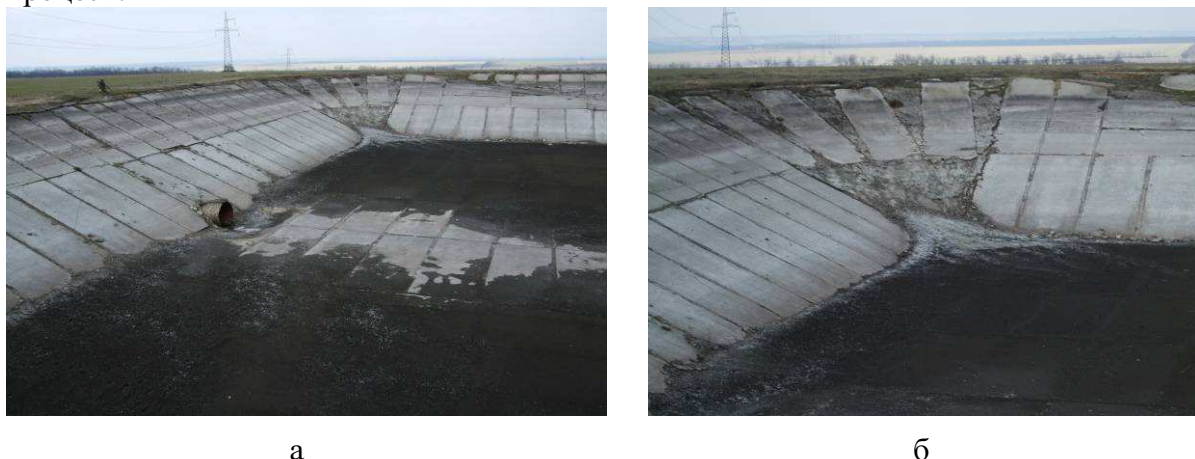
Рисунок 6 – Підвідна труба (а) та зона зчленування північного і східного бортів (б) Калинівського регулюючого басейна
