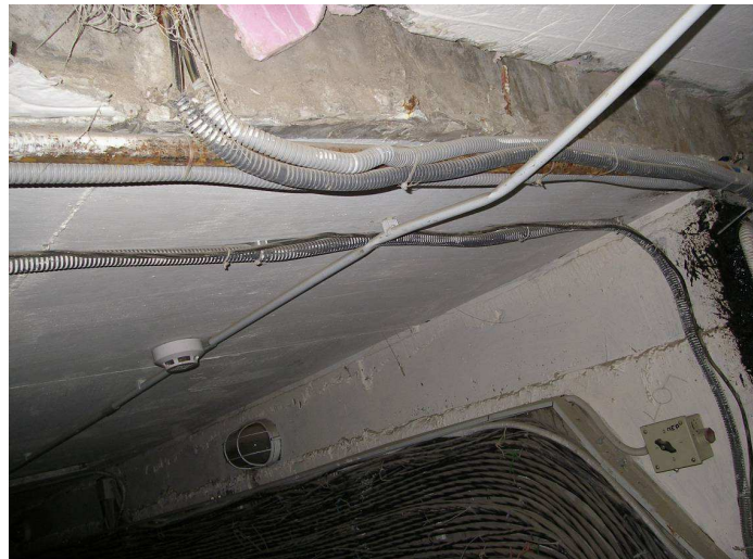
Рисунок 7 – Стан конструкцій підсилосної галереї в місці деформаційного шва через нерівномірні осідання основ фундаментів зерносховищ
