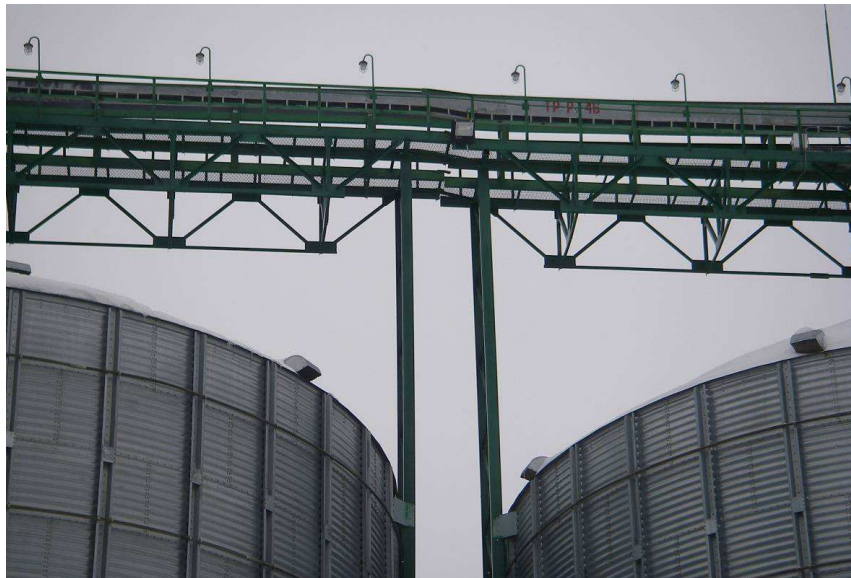
Рисунок 8 – Руйнування вузла надсилосної галереї внаслідок нерівномірного осідання фундаментів
