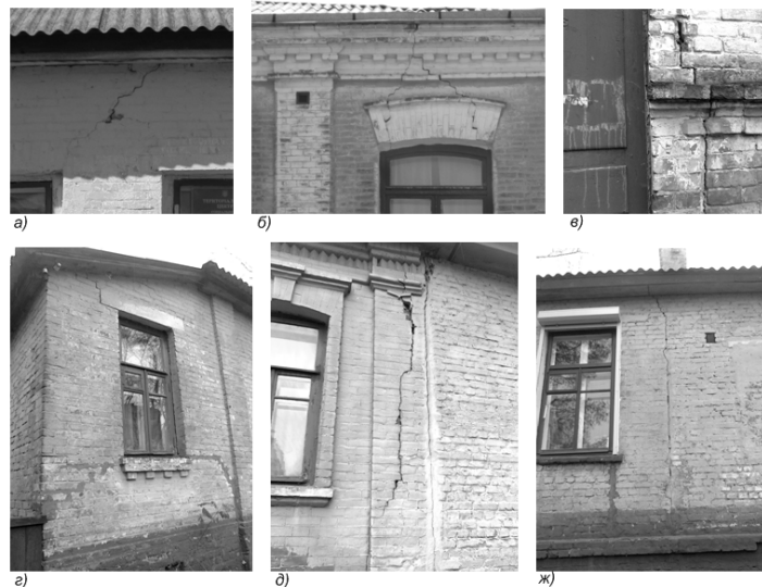
Рисунок 2 – Деформації будинків м. Чернігова: а) одноповерхова будівля по вул. Льва Толстого; б) двоповерхова будівля по вул. Льва Толстого; в), г), д) житлові одноповерхові будинки по вул. С. Русової; ж) житловий одноповерховий будинок по пр. Миру
