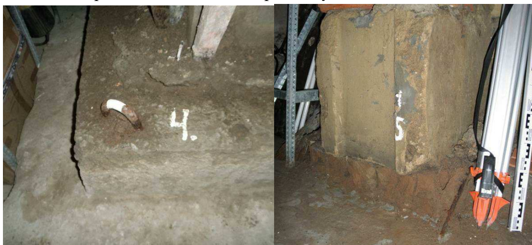
Рис. 2. Деформаційні марки, встановлені в підвалі будівлі по вул. Грушевського, 21 у м. Полтава на фундаменті колони та в стіні
