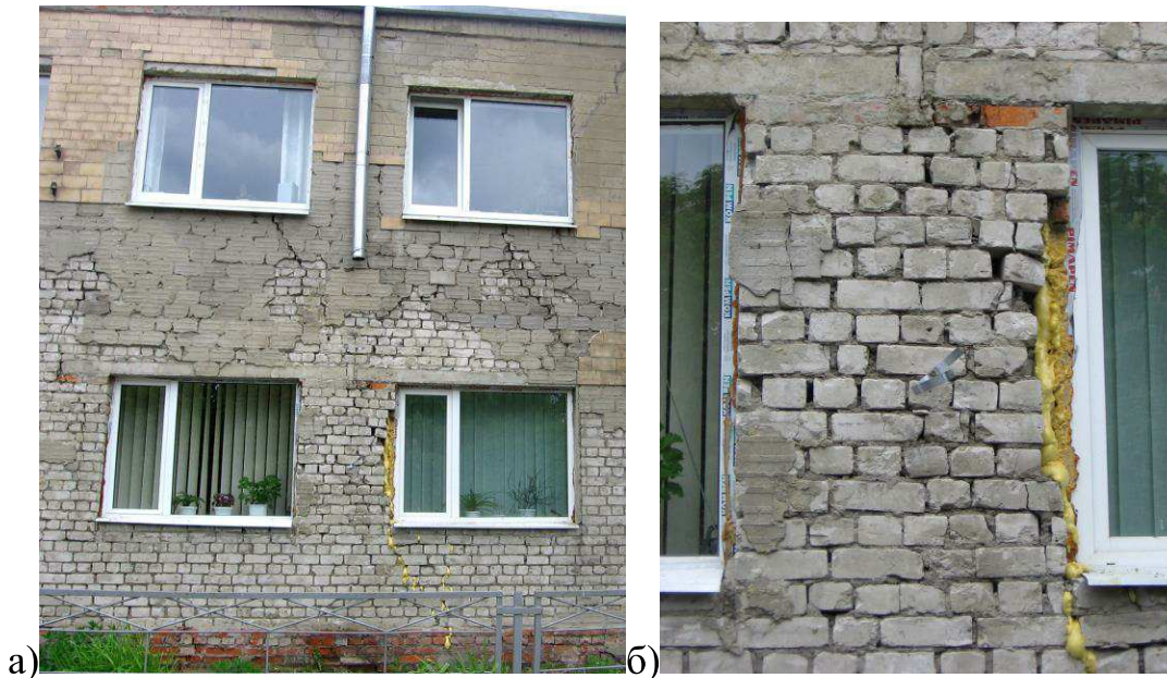
Рис. 6. Деформации в кирпичной кладке главного фасада здания библиотеки: а) участок стены; б) простенок
