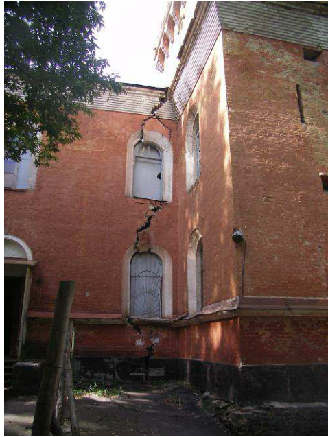
Рис. 6. Деформації стін будівлі, викликані нерівномірним осіданням основи, липень 2013 р.
