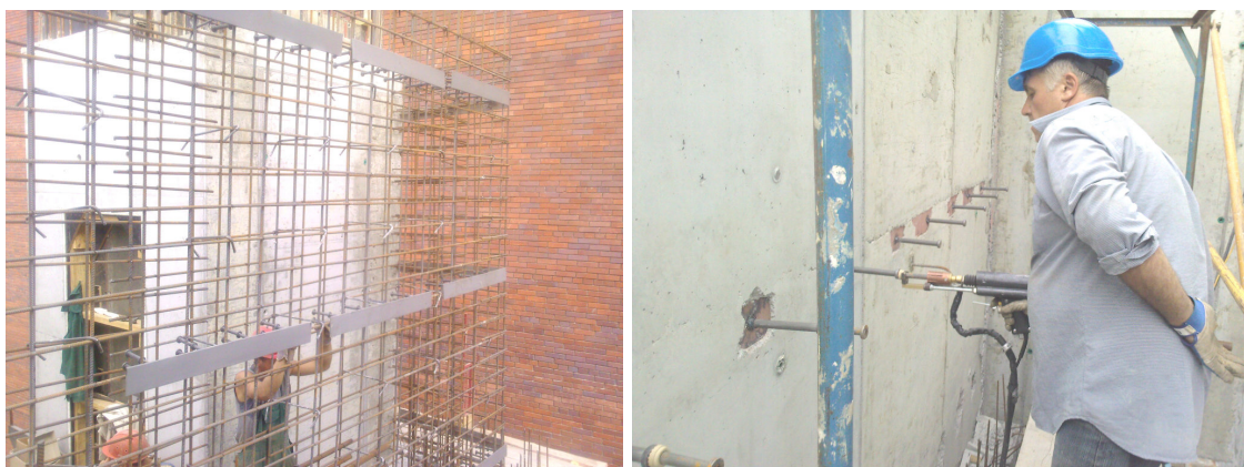
Рис. 4. Улаштування монолітної стіни із закладними деталями та наступне приварювання до них анкерних стрижнів
