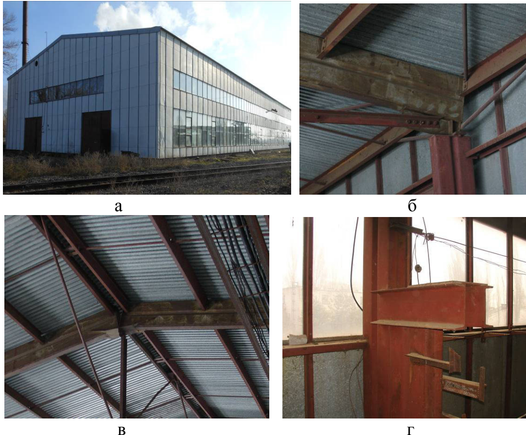
Рис. 1. Виробничий корпус у м. Комсомольськ: а – загальний вигляд; б – опорний вузол ригеля; в – гребеневий вузол ригеля; г – підкранова частина колони каркаса з холодногнутих профілів
