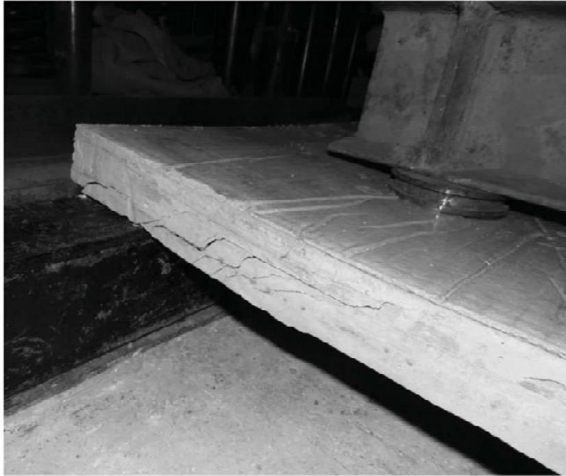
Рис. 5 – Руйнування опорної зони плити
