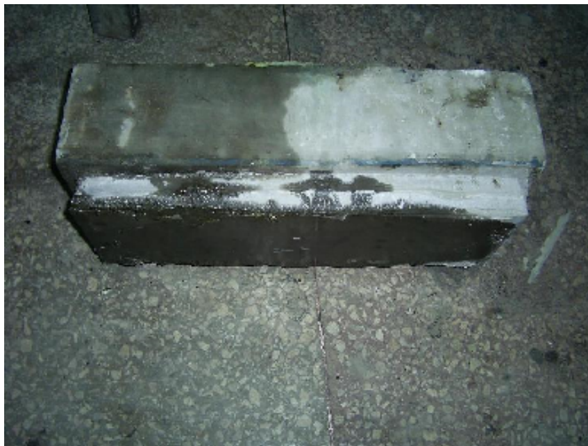
Рис. 6 Прокладний шар із SikaGrout-316 після завершення динамічних випробувань і розбирання моделі: стан добрий, виявлено 2 поперечні тріщини з розкриттям не більше 0,3 мм
