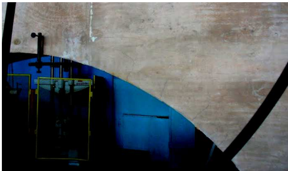
Рис. 10. Появление трещин на нижнем контуре арочного свода бора
