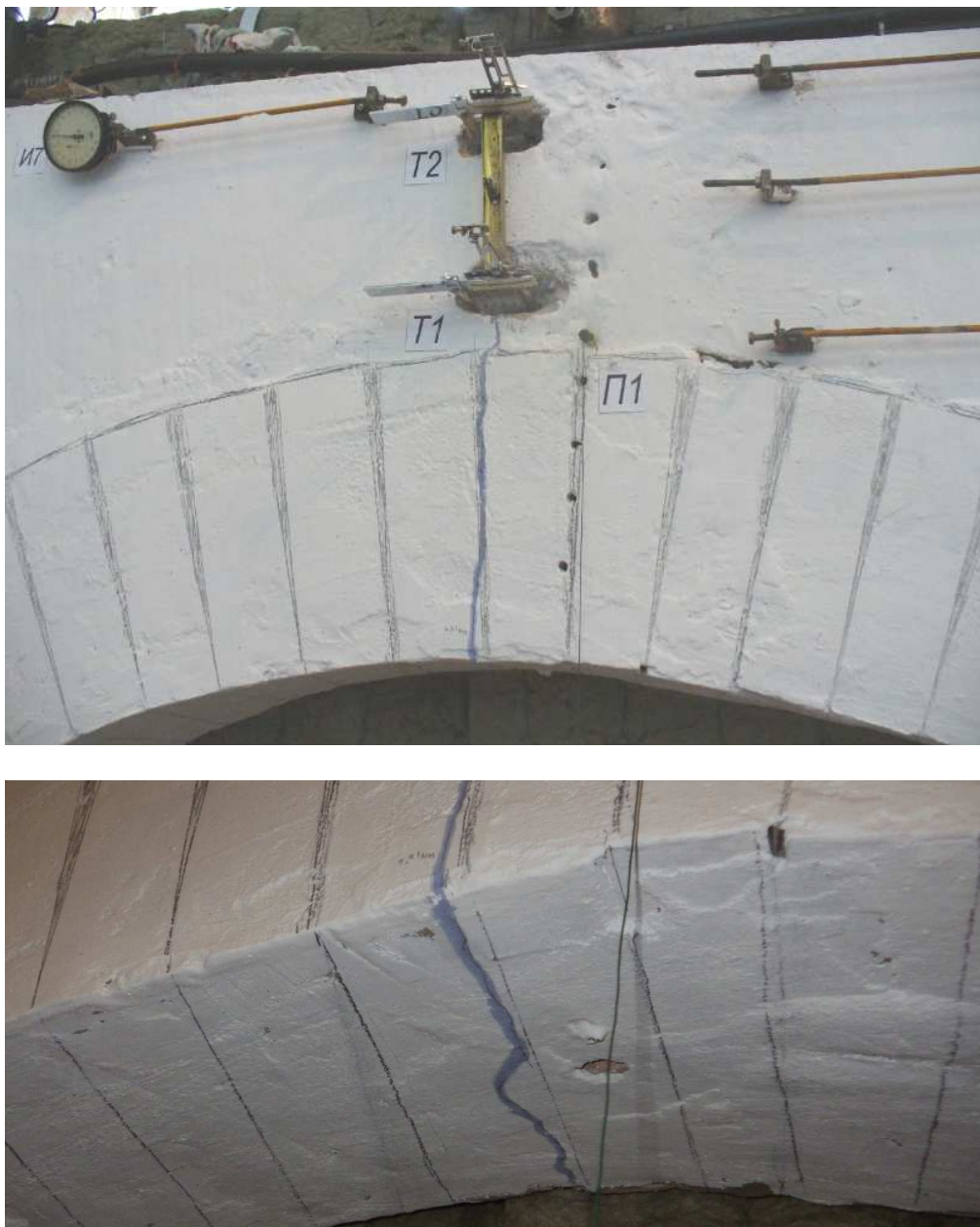
Рис. 7. Установка рычажных тензометров Т1 и Т2 и появление трещины в нижней части фрагмента железобетонного борава №1 и в футеровке
