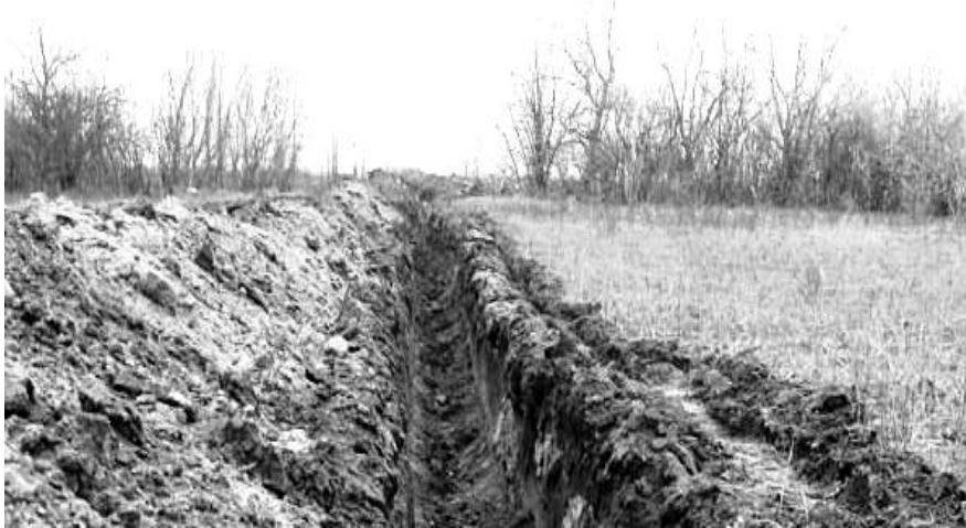
Рисунок 6. Зруйнована зрошувальна мережа в Придунайському регіоні Одеської області
