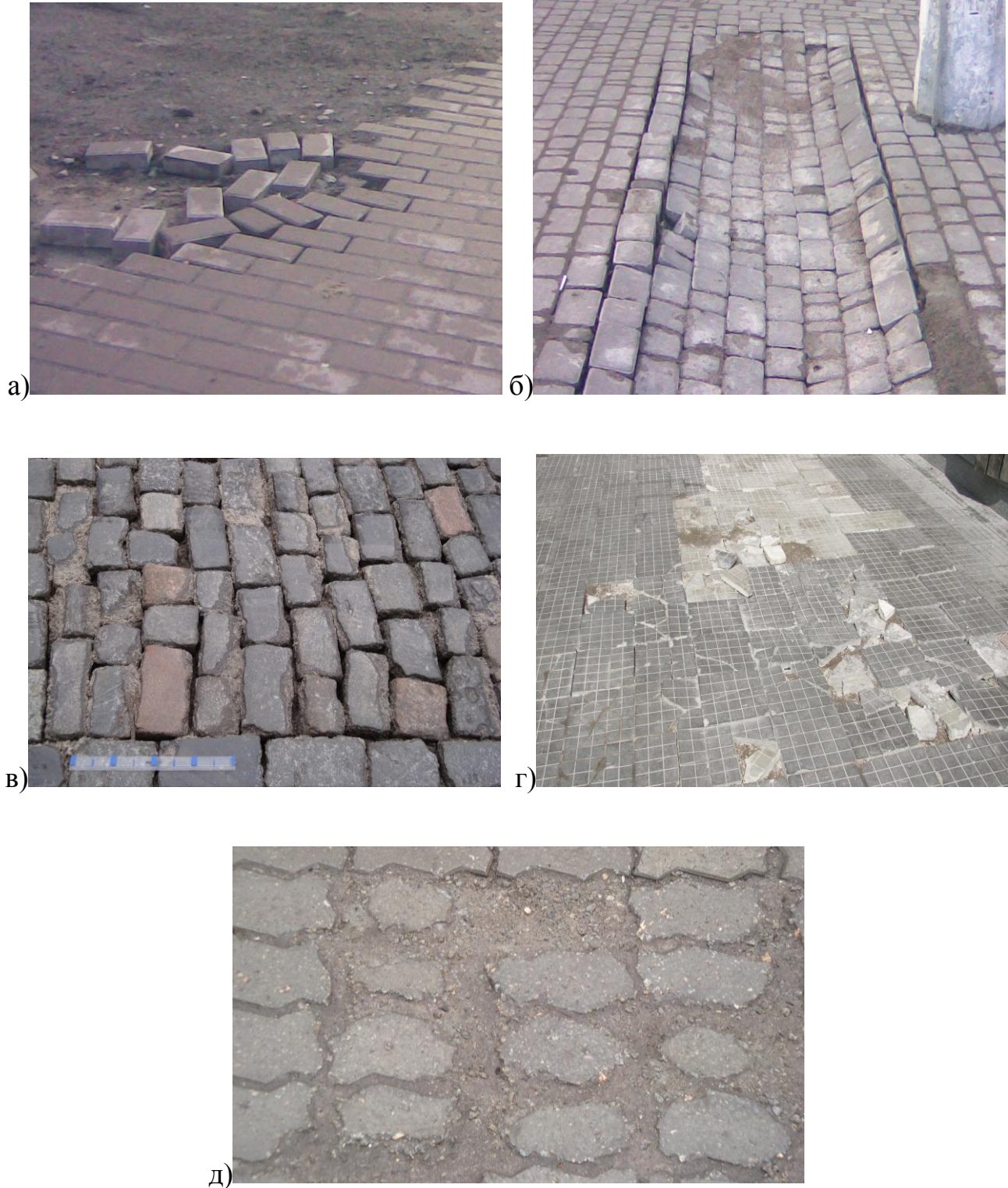
Рис. 8. Приклади руйнувань мостових:
