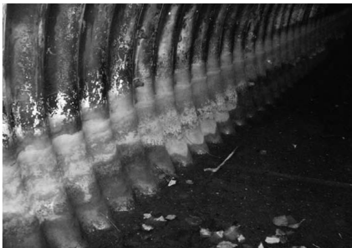
Рисунок - 4 Нарушение обмазочной гидроизоляции и коррозия
