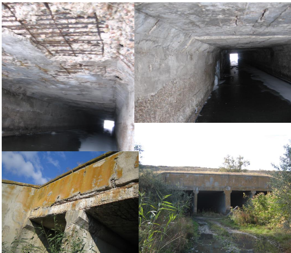
Рисунок 2 – Примеры характерного разрушения бетона водопропускных сооружений
