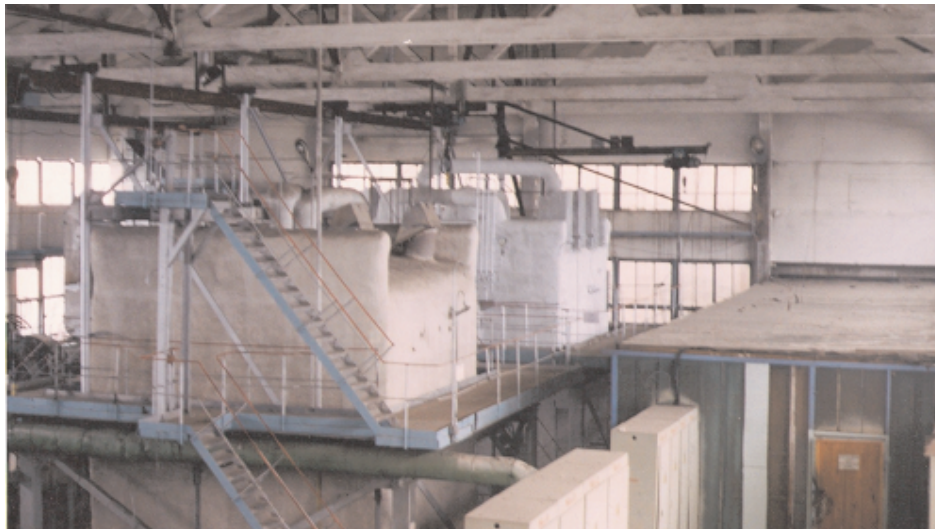
Рис. 2. Котел КВ-ГМ-42 (на втором плане)
