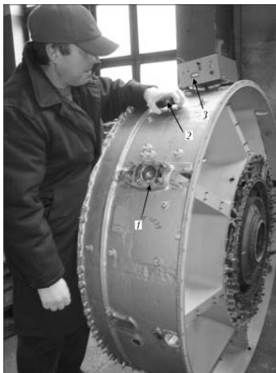
Рис. 4. ЭДО ПКА в зоне ремонтной наплавки усиления под фланец крепления трубопровода охлаждения стойки: 1 — усиление под фланец; 2 — ручной инструмент для ЭДО; 3 — источник питания для ЭДО
