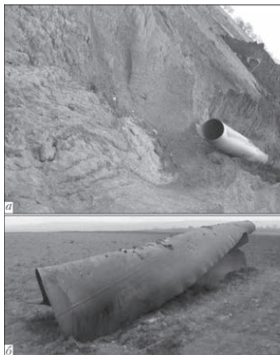
Рис. 1. Стресс-коррозионное разрушение магистрального газопровода диаметром 820 мм (а) и фрагменты разрушившихся труб (б)
