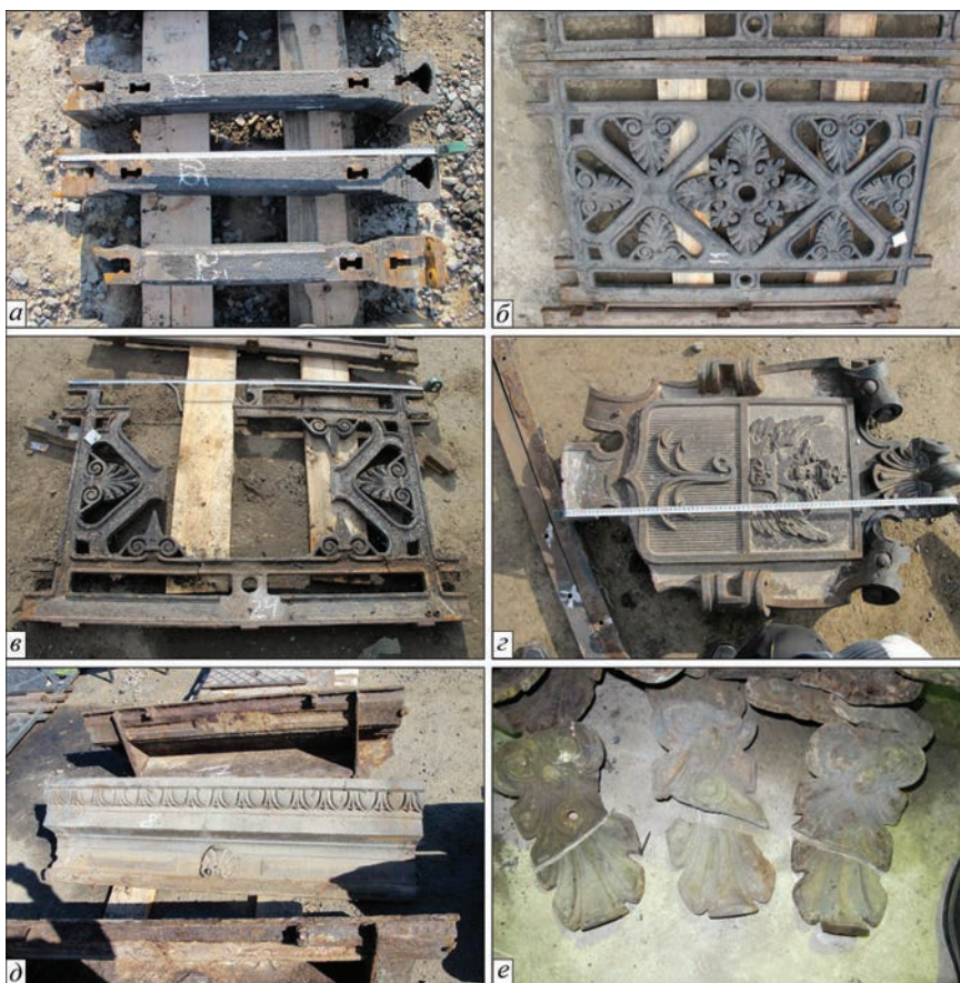
Рис. 4. Примеры состояния характерных деталей перильного ограждения: установленного при экспертном осмотре: a — столбы №№ 25, 26, 27; б — решетка №11; в — подгербовая решетка № 24; г — герб № 1; д — карниз № 8; е — угловые элементы декора № 1, 2, 3
