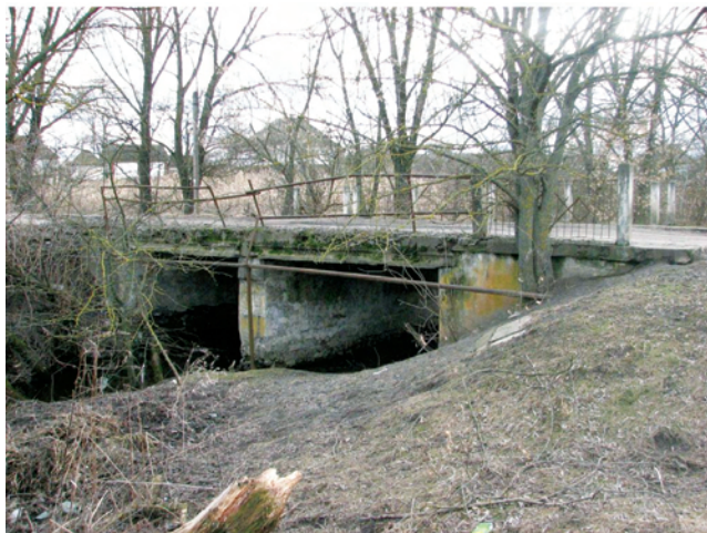
Рис. 1. Міст с. Веприк Гадяцького району до ремонту
