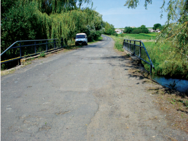
Рис. 5. Міст с. Вільниця Чутівського району до ремонту
