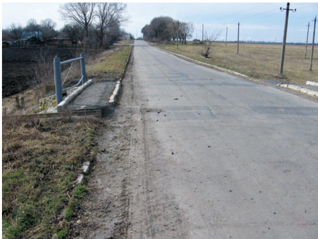
Рис. 3. Міст с. Степне Полтавського району до ремонту
