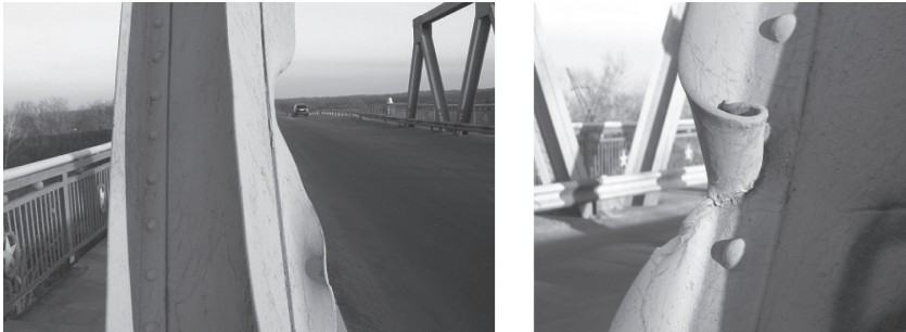
Рис. 1. Пошкодження елементів форми мосту внаслідок ударів транспорту, ширина проїзної частини 7 м
