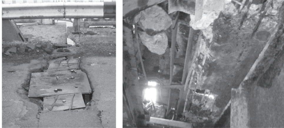
Рис. 1. Руйнування деформаційного шва
