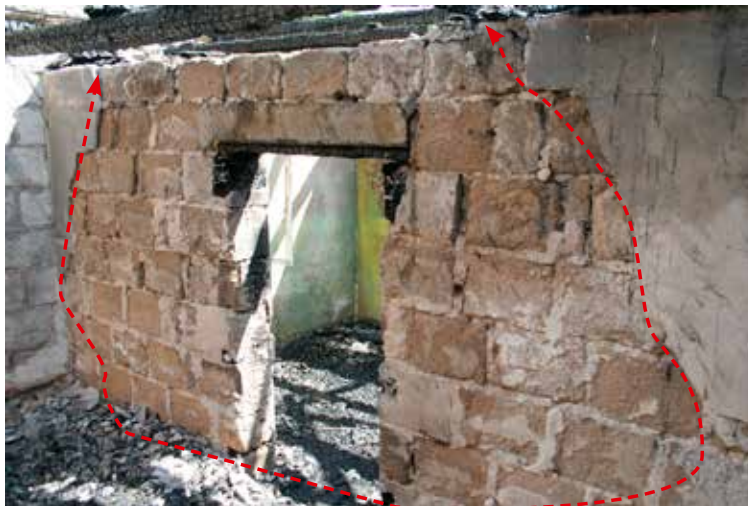
Ryc. 5. Widok ubytków tynku na ścianie pokoju (zaznaczono tak zwany: „śląd stożka pożarowego”)
