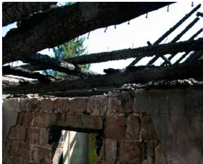
Ryc. 4. Widok belek konstrukcyjnych w prawie doszczętnie spalonym pokoju, w którym później znaleziono szczątki ofiary zdarzenia
