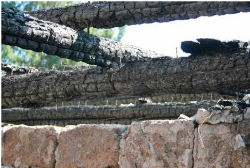
Ryc. 3. Zbliżenie przewężenia belki konstrukcyjnej nad otworem drzwiowym Fig. 3. A close up view of a constricted construction beam above the door opening
