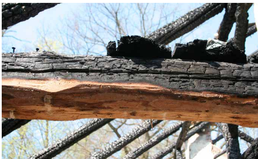
Ryc. 2. Widok sposobu nadpalenia belki w przedpokoju budynku, w którym podłożono ogień
