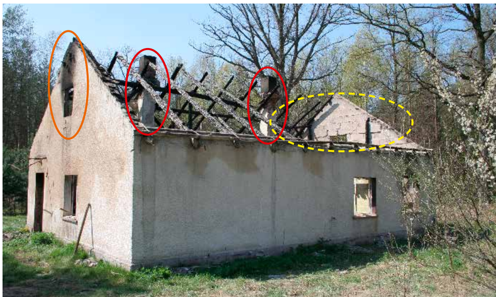
Ryc. 1. Widok domu i jego usytuowania w terenie, wraz z oznaczeniem pomarańczowym owalem okna – wydostawania się dymu, czerwonym – nieczynne przewody kominowe oraz zaznaczeniem żółtą obwódką miejsca po pokoju, w którym znaleziono szczątki zwłok ludzkich
