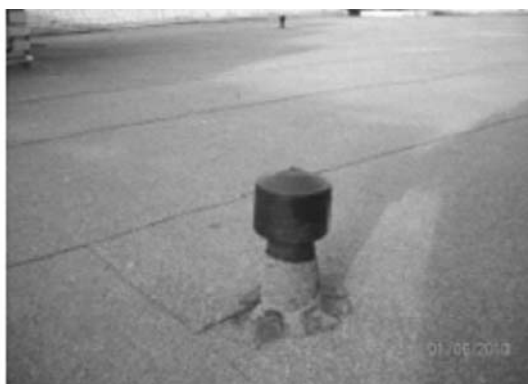
Рисунок 4 - Загальний вид аератора на покрівлі
