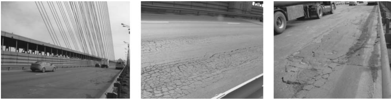
Рисунок 1 - Стан покриття проїзної частини ортотропної плити Південного мостового переходу (напрямок руху: вул. Саперно-Слобідська – проспект Бажана), 14.04.2011 р.
