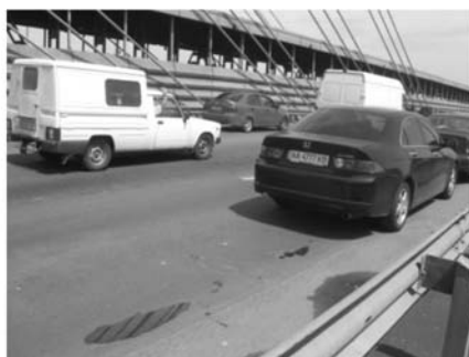
Рисунок 6 - Стан дорожнього покриття на ортотропній плиті ПМП
