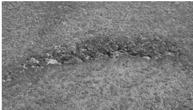
Рисунок 1 - Початкова стадія руйнування залізобетонної конструкції
