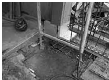
Фото 6 - Повреждение гидроизоляционного слоя в процессе производства смежных работ
