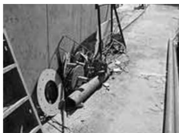
Фото 7 - Повреждение гидроизоляционного слоя в процессе складирования громоздкого оборудования
