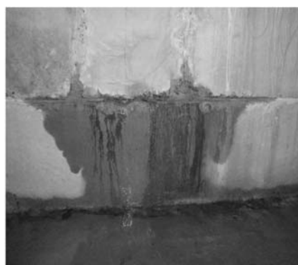
Фото 9 - Нарушение герметичности конструкции в результате повреждения гидроизоляционного слоя
