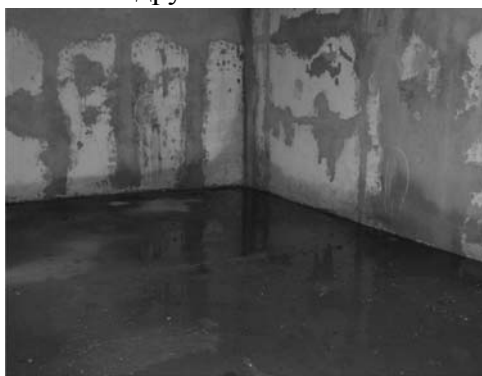
Фото 3 - «Отказ» работы гидроизоляции в подземных паркингах
