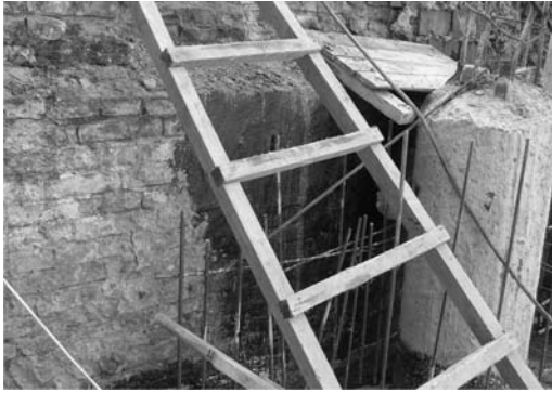
Фото 4 - Гидроизоляция подземной части здания с противоположной стороны воздействия воды
