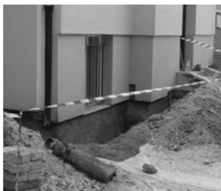
Фото 8 - «Отказ» работы гидроизоляции из-за неправильно выбранного слоя гидроизоляции
