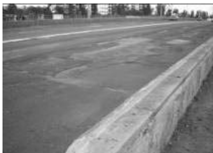
Рисунок 1 - Автодорожній шляхопровід (р-к Юність) обстеження - 2010 р.
